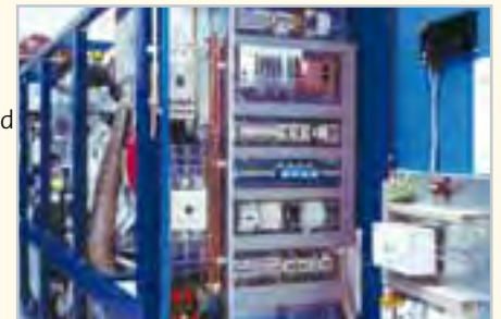
Mini-Blockheizkraftwerk von innen
