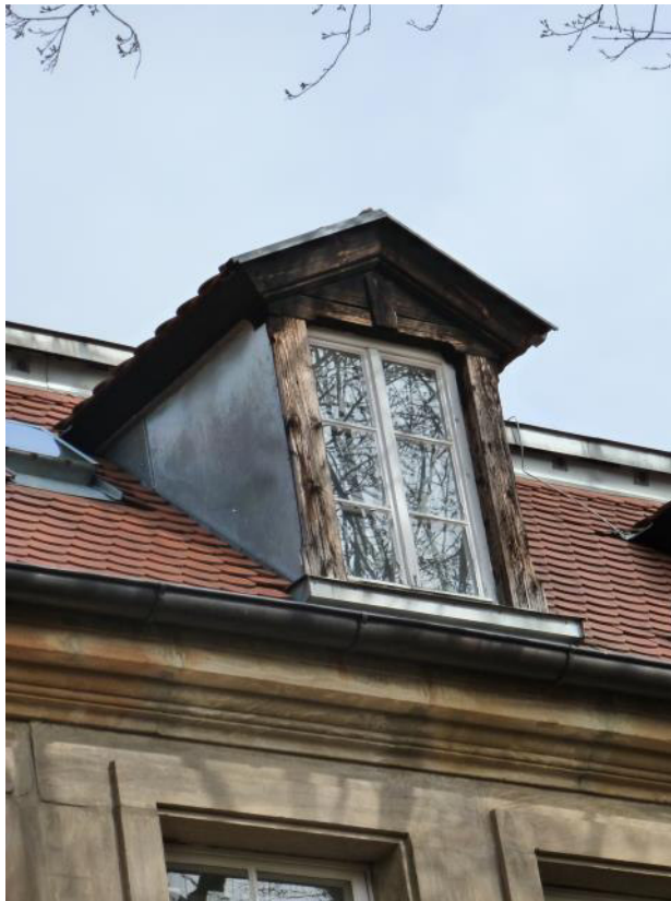
Holzschäden an Fenster und Gaube
