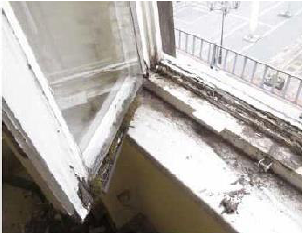
Substanzverlust im Bereich der Fenster
