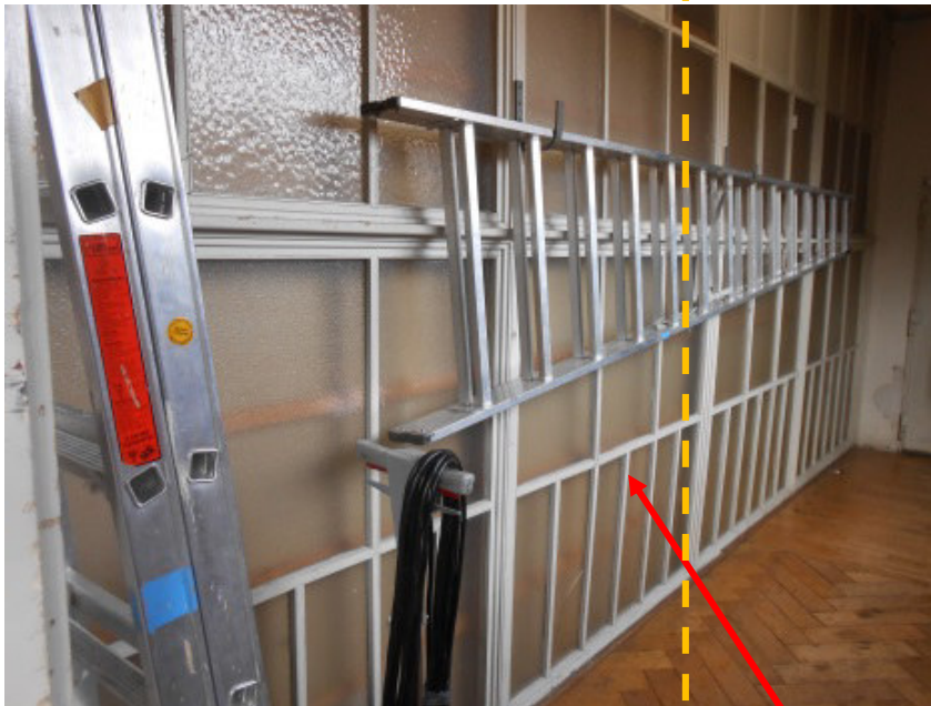
Lotabweichung der Trennwand
