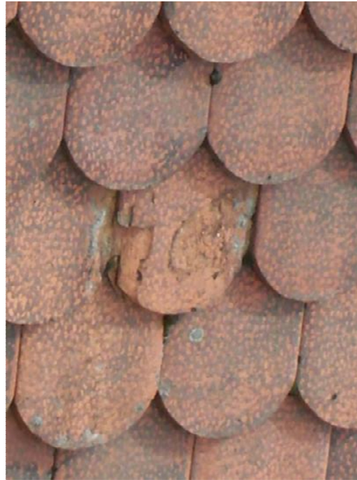
Substanzschäden an der Dacheindeckung
