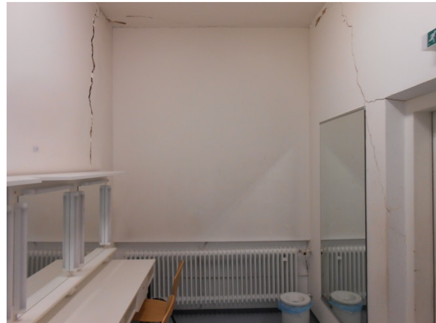
Rissbildung Garderobe Kl. Haus
