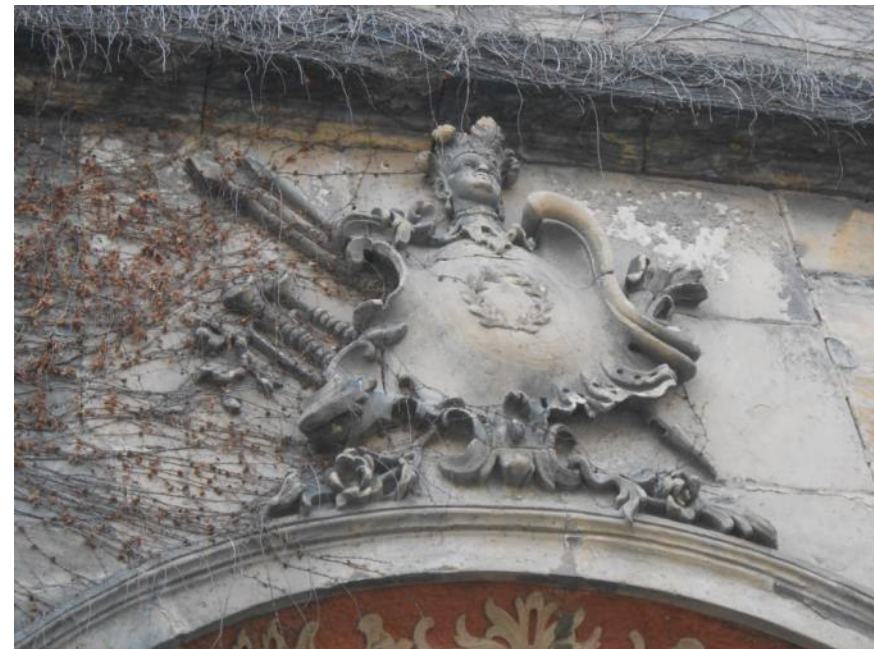
Substanzschäden an histor. Wappen Ludwigstr.
