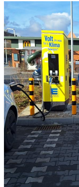
Bild 37: Ludwig-Thoma-Straße - Ladesäule E-Autos
