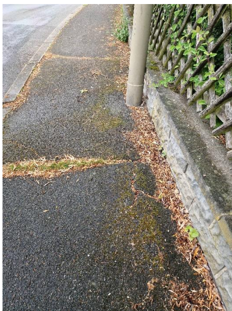
Bild 108: Wolfsbach (5) – beschädigter Gehweg in Wolfsbacher Straße
