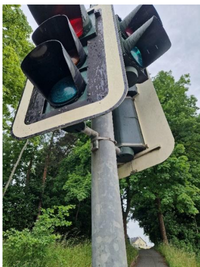
Bild 111: Wolfsbach (9) – Ampelanlage Bundesstraße 2
